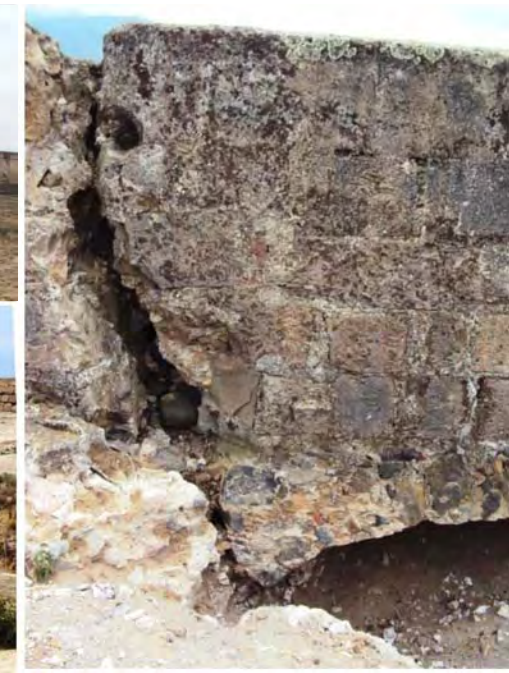
BALUARTE SUR ORIENTE CON EVIDENCIAS DE DAÑO POR EXPLOSIÓN DEL POLVORÍN
