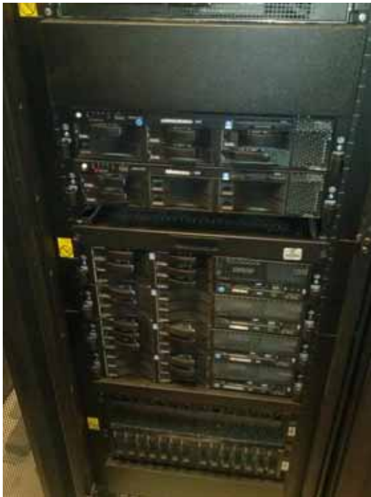
Imagen 3: Rack de servidores viejos que albergaban el sistema Dalet
