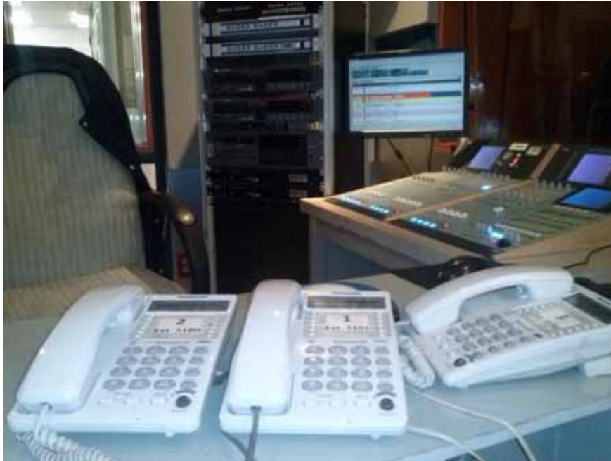
Imagen 13: Equipos telefónicos analógicos usados para enlaces con la consola de transmisión.
