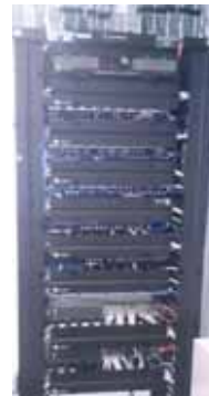
Imagen 7: MDF con los switches de la estructura de red de la planta baja
