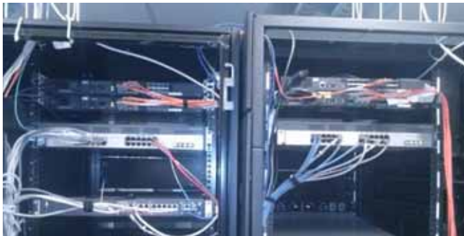
Imagen 6: Nuevos switches de fibra óptica y Ethernet instalados para el sistema Dalet
