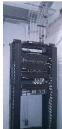
Imagen 10: IDF ubicado en el sótano
