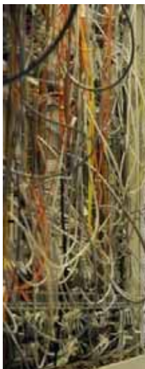
Imagen 8: cableado anterior en desorden
