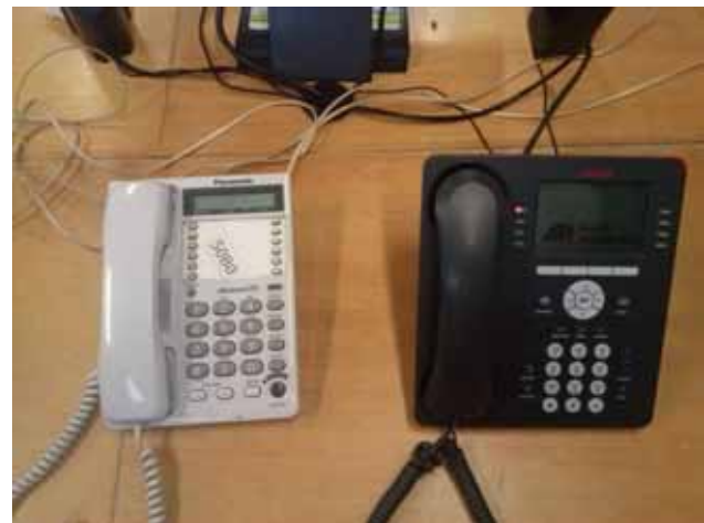
Imagen 12: Equipos telefónicos analógicos y VoIP en el área de noticias
