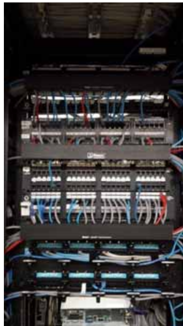
Imagen 3 (Patch Panel en sitio)
