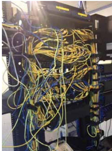
Figura 19. Rack en malas condiciones
