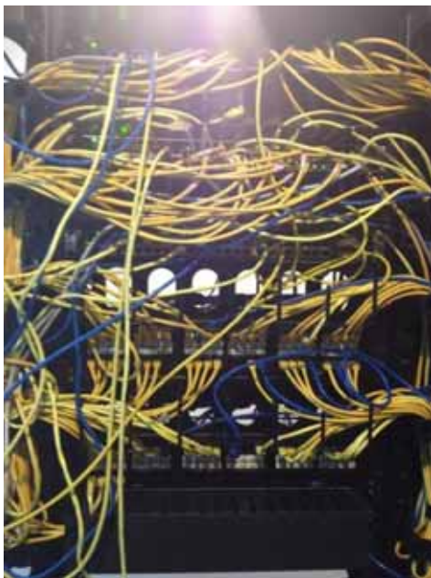
Figura 18. Rack en malas condiciones
